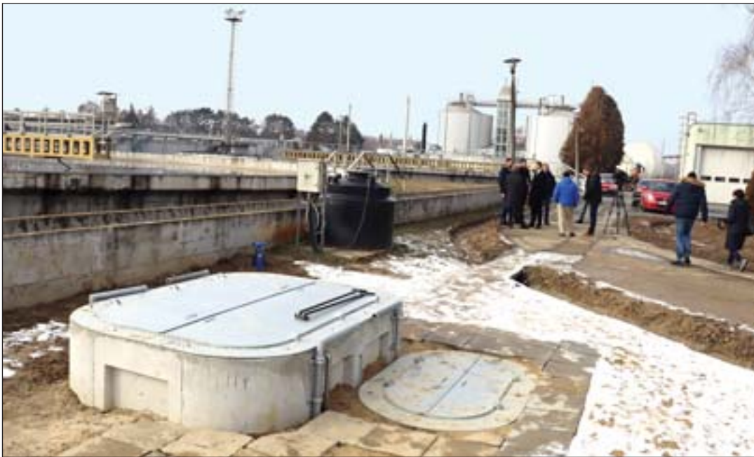
Előtérben a hőszivattyús rendszert tartalmazó akna.
